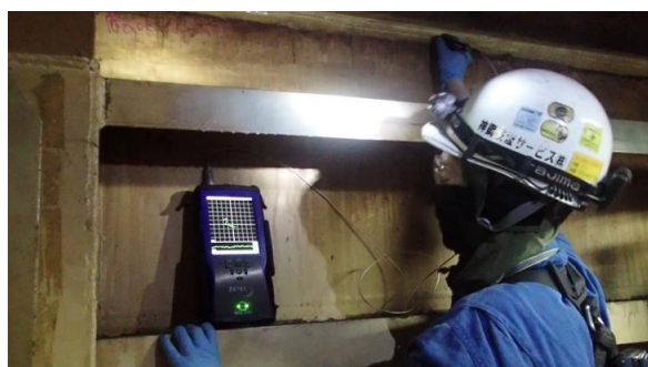
溶接部のき裂を塗膜の上から探傷
